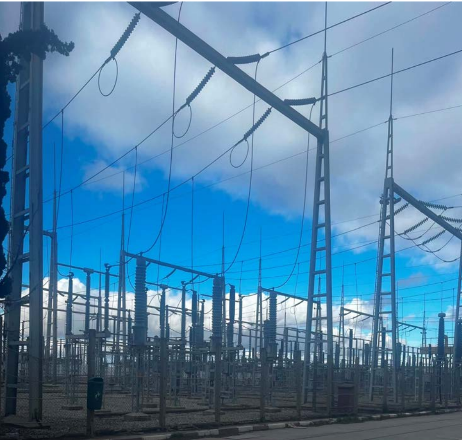
Image d'un poste électrique prise à la centrale électrique de Radès (Tunisie)
