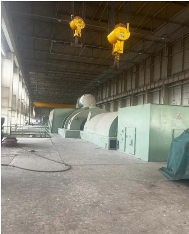
Turbine à vapeur
