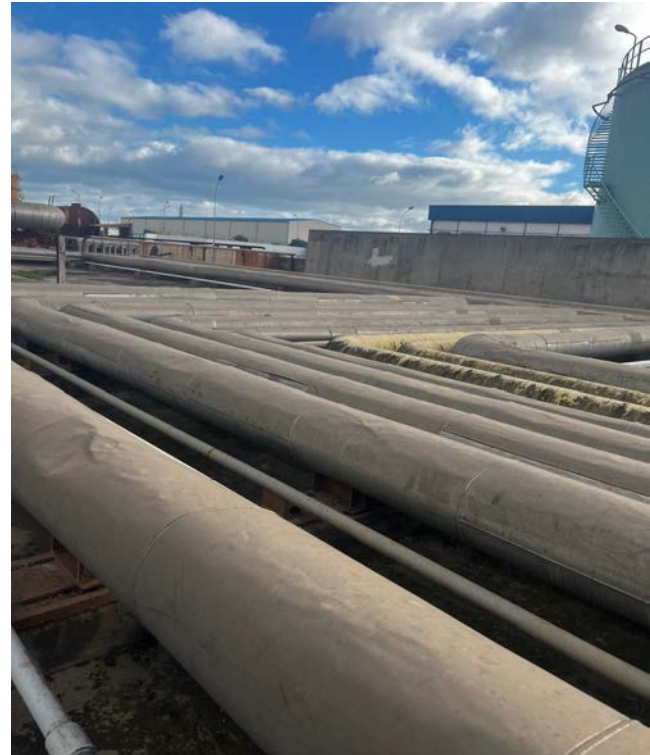
Conduites d'amenée d'eau de mer
